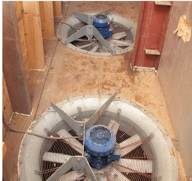
In de koeling heeft de Zeeuwse akkerbouwer frequentieregelaars op de ventilatoren die een forse energiebesparing geven.
